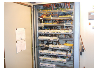
připojení kabelů a termostatů v rozvaděči
