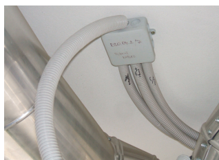
připojení topných kabelů
