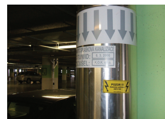
vyhřívaná potrubí kanalizace
