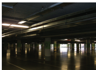
prostory s potrubím
