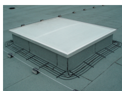
detail instalace topného kabelu okolo světlíku
