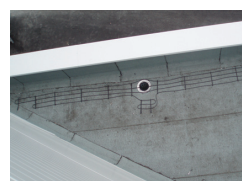
topný kabel okolo střešní vpustě a na okraji střechy
